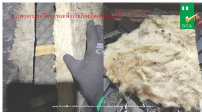
ภาพที่ ๒ การตรวจสอบหลังเพลิงไหม้ พบการใช้วัสดุติดไฟอุดตามช่องเปิดตามผนังเพื่อกันเสียงเด็ดลอดออกนอกอาคาร [ภาพโดยความอนุเคราะห์ของสมาคมผู้ตรวจสอบอาคาร]
